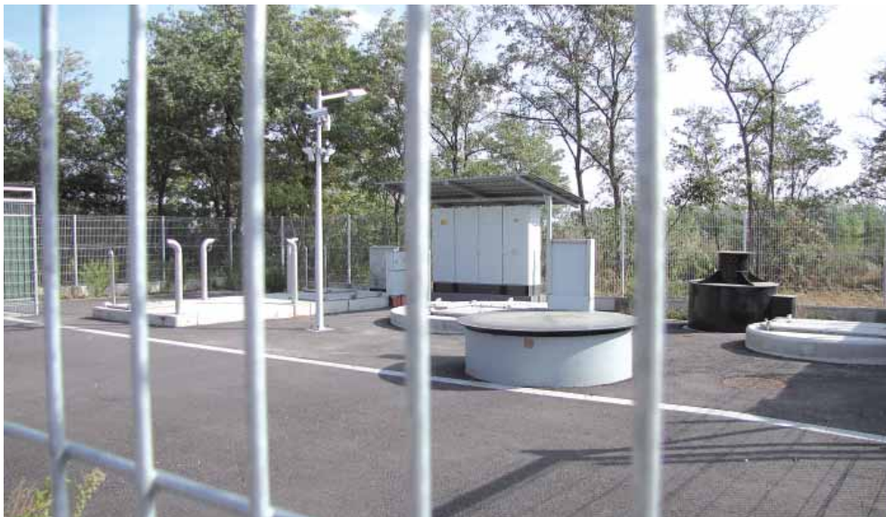
Szennyvízátelő telep Ecser határában. A testület megvizsgálja annak lehetőségét, hogy a község szennyvizeinek fővárosi csatornahálózatba történő elvezetését a meglévő vezetéken, illetve az Ecser Közmű Kft. által a jövőben kiépítendő további – mintegy 135 méteres – csatornavezetéken biztosítsa.
